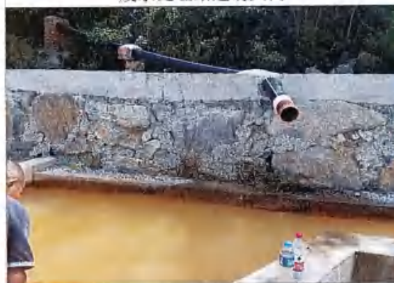
渗滤液收集管
