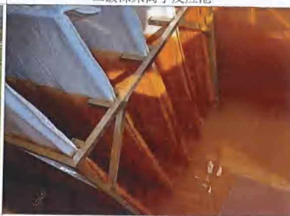
污泥浓缩装置
