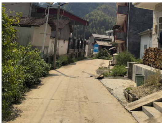
老路路基路面现状
